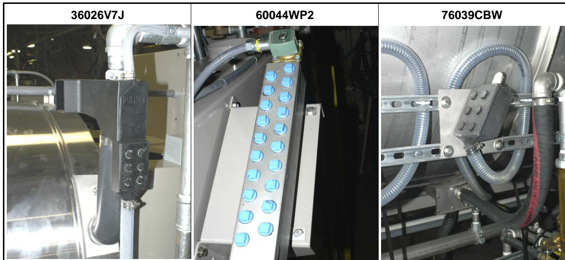
Imagem 8: Tubos de distribuição de entrada de produtos químicos para sistemas de bombas de produtos químicos. Consulte o relatório de cuidado 23 . Estes são apenas exemplos. Sua máquina pode ter outra aparência.
